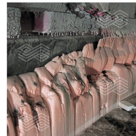
Плитки для горячего ремонта DURITAL RK30NP после трех лет работы в печи / DURITAL RK30NP overcoating tiles after three years
