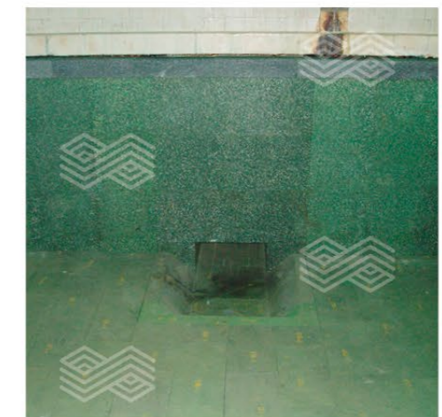
Область протока печи для производства стекловолокна, выполненного из хромкорунда, после холодного ремонта. / Chrome corundum throat area in a rebuilt fiber glass furnace
